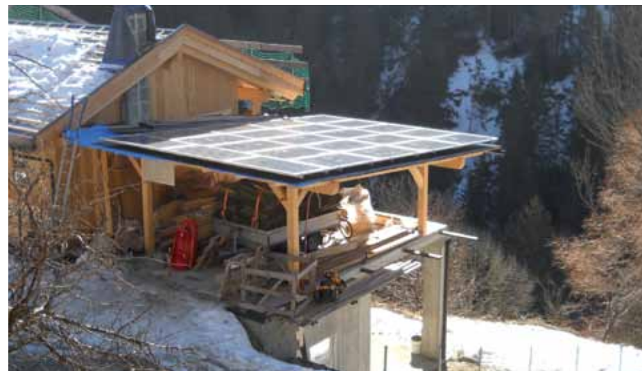
Elpo | St Vigil Enneberg - Italie Installation: 5,29 kW | Système de vis à double filetage
